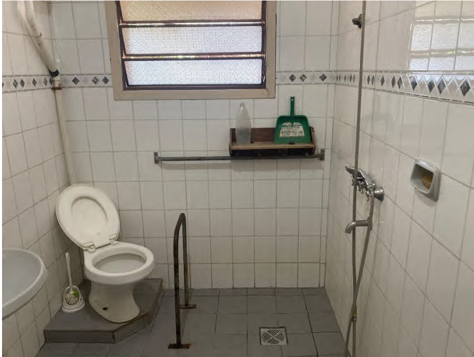
Sanitarios de las habitaciones de alojamiento en el sector de Chacoheim
